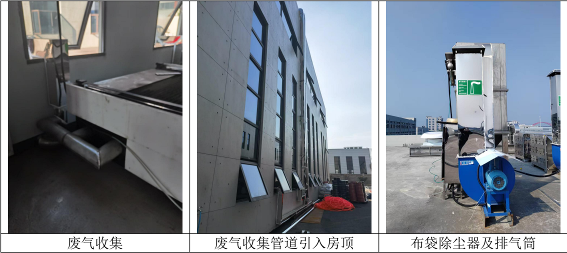
图 3-2 本项目已采取的废气治理设施现场图片
