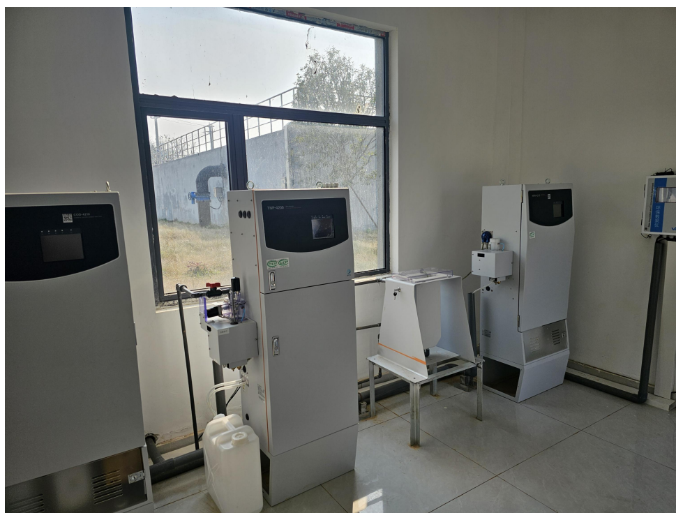
厂区进出水在线监测设备
