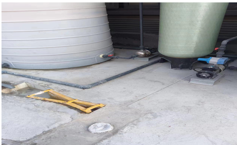
新建的生产废水排放口
