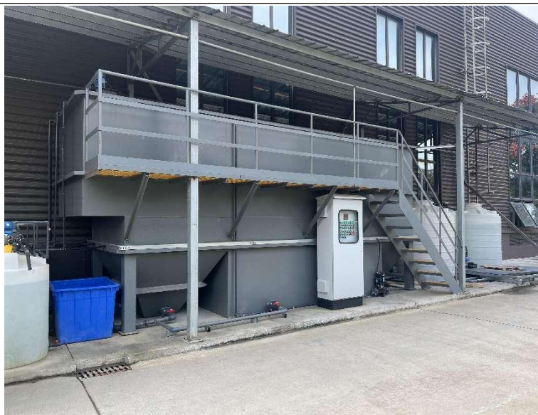
新建的 2#污水处理站
